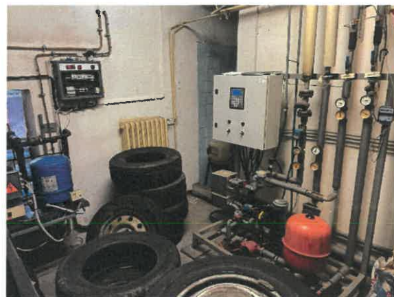
1.PP VÝMĚNÍKOVÁ STANICE
